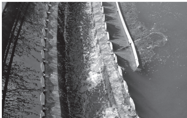
二沉池出水堰
